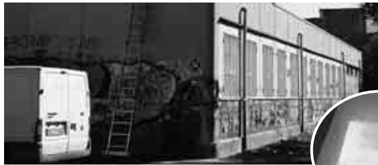
Nella foto sopra: l'Ite «Russo», gravemente danneggiato dalle infiltrazioni d'acqua; sotto un particolare del soffitto di un'aula del III Circolo didattico, nel plesso centrale di via Pietro Lupo
